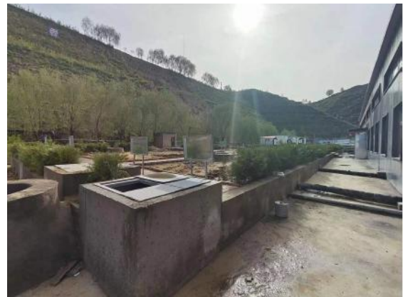
工业场地生活污水处理站
