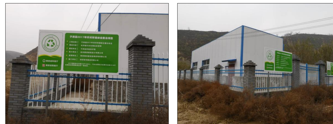
已建成的电市镇污水处理站
